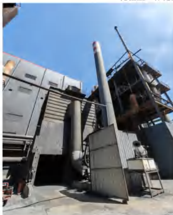
二次配料除尘器
