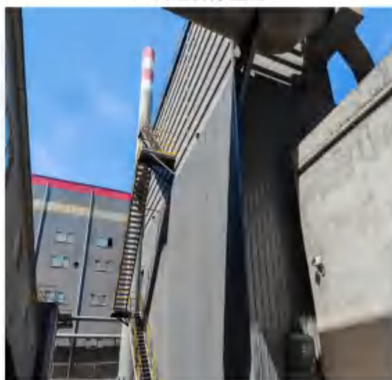
链篦机-回转窑除尘装置
