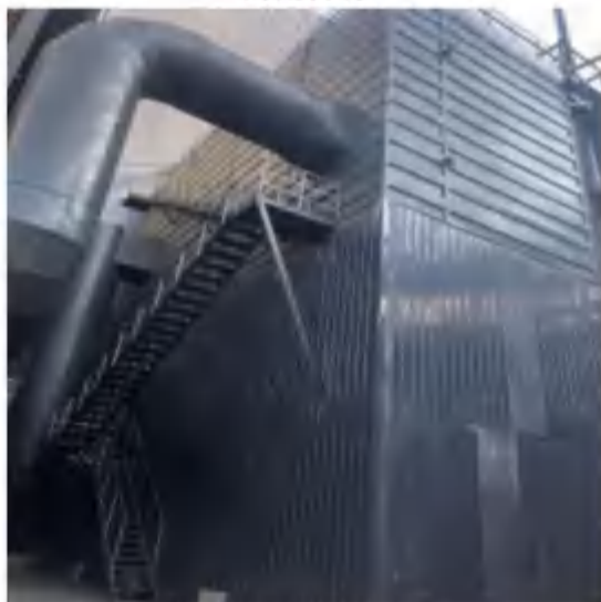
炉前排烟布袋除尘器
